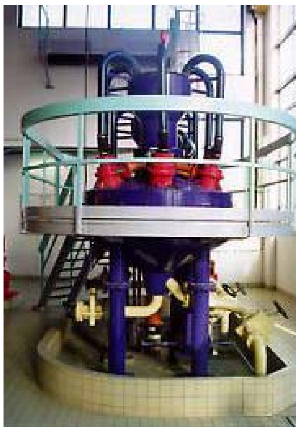
1. Uklanjanje mulja , 2. Influent - otpadna voda, 3. Efluent - prečišćena voda Na slici 2. je prikazan Hidrociklon koji se koristi u Actiflo procesu Slika 26 - Hidrociklon koji se koristi u Actiflo procesu
